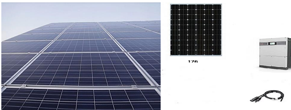
Рис. 1. Солнечная сетевая электростанция «GWS Energy»
