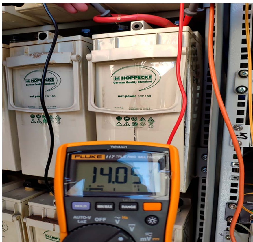
Рисунок 2 – Повреждённая аккумуляторная батарея в телекоммуникационном шкафу MSAN
