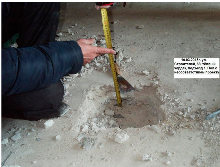
Рисунок 1 – Поверхность пола теплого чердака, не соответствующая проекту
