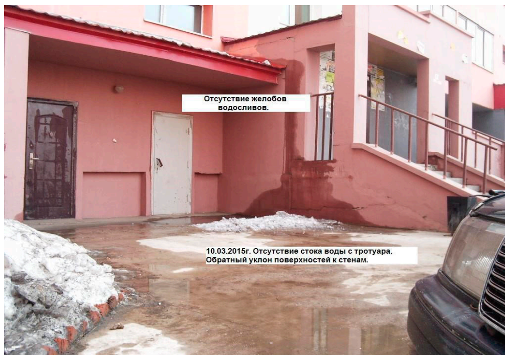
Рисунок 2 – Отсутствие стоков воды с тротуара
